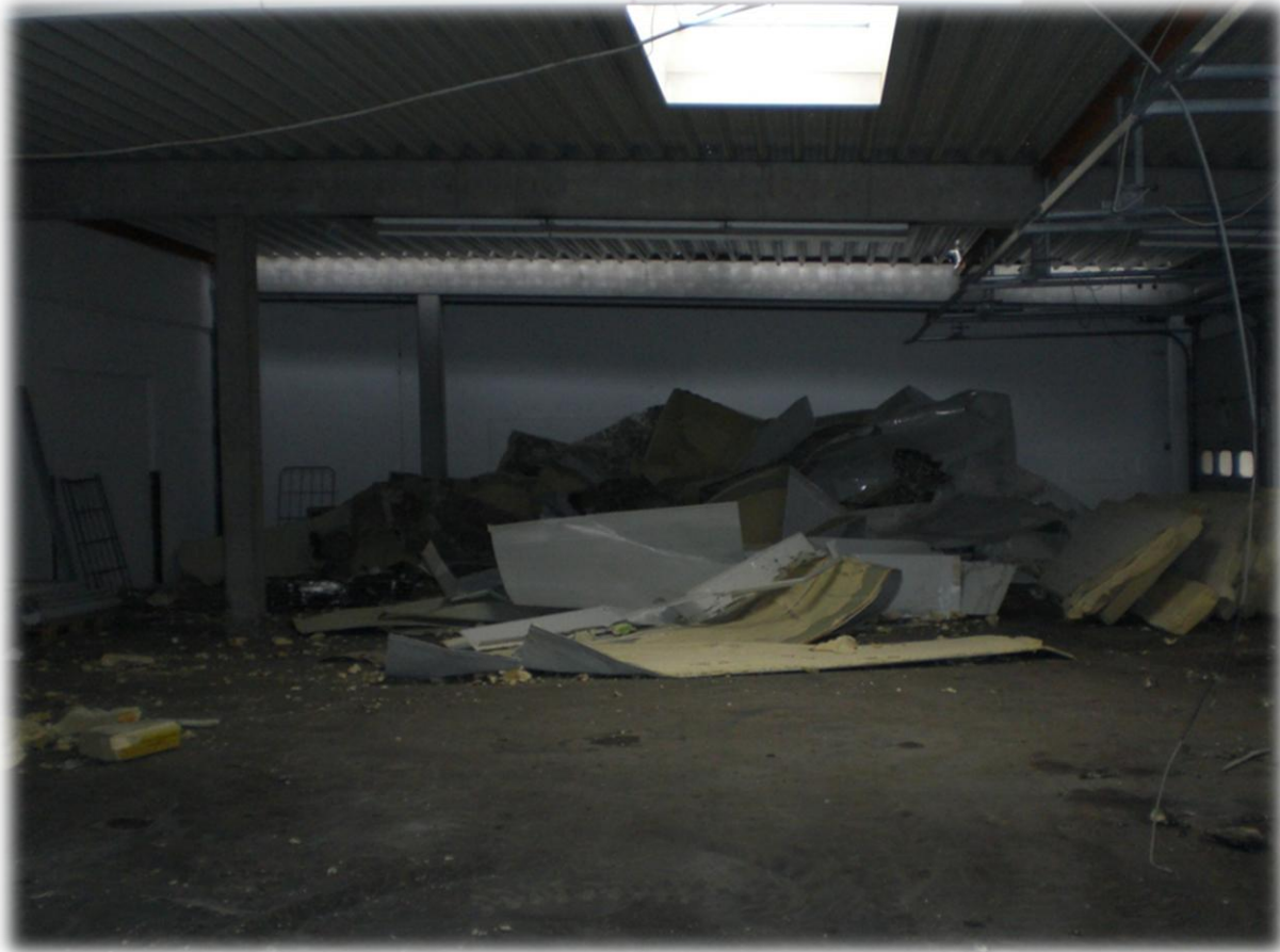
Material an Tor 9! Ach ja: Ohne Dach.
